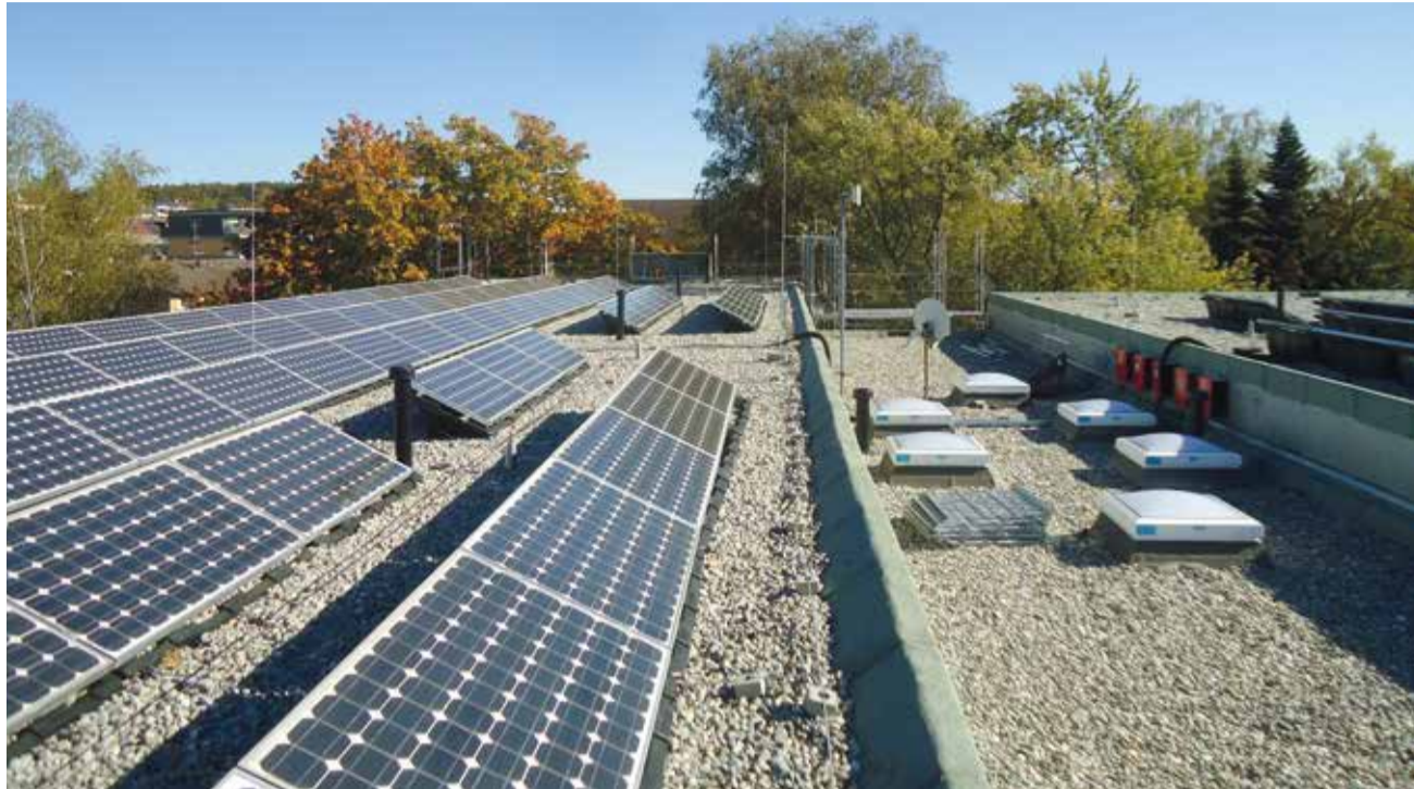
Photovoltaikanlage auf dem Dach der Berchenschule. Die energetische Sanierung der Konstanzer Schulen gehört zu den Schwerpunkten der Klimaschutzbemühungen.
