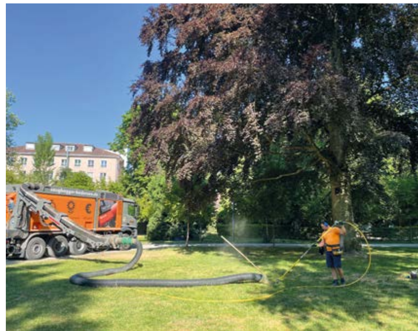
Auch im Erdreich rund um die Blutbuche im Stadtgarten wurden Sensoren eingebracht, die Daten zum Wasserbedarf des Baums liefern.
